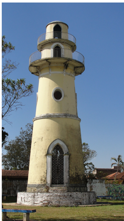
Imagem 47 – Atual estado de conservação do Holofote. Fonte: fotografia do autor.
