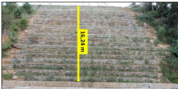
Figura VI – Distância Vertical aproximada do talude Fonte: os autores.
