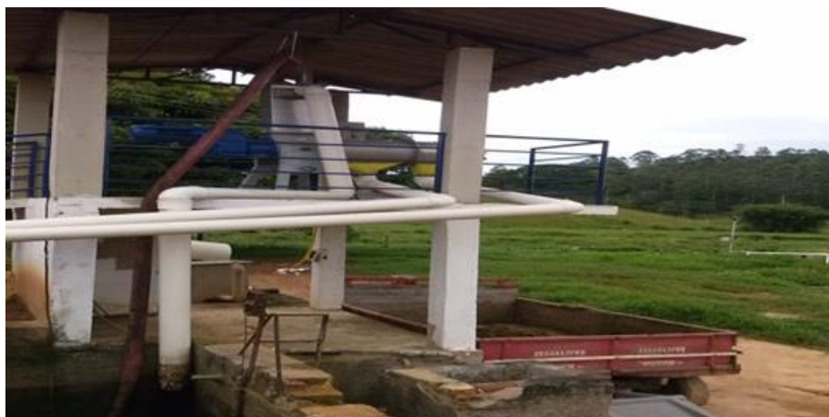
Figura 5: Peneira separadora para a extração de partículas sólidas antes da entrada do afluente no biodigestor.
