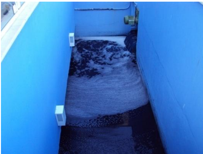
Figura 7: Tanque de Equalização – WashBrasil.
