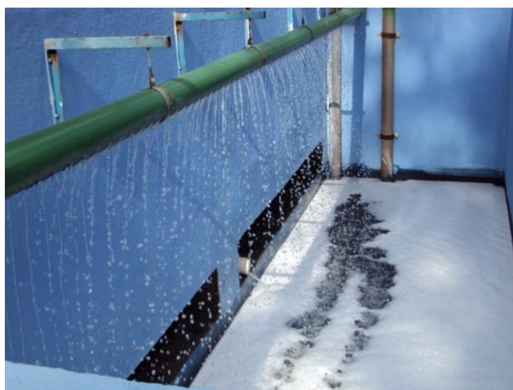
Figura 14: Tanque de água tratada – WashBrasil.
