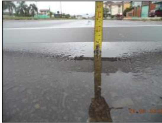
Figura 23- Afundamento de trilha de roda em um trecho de uma rodovia.
