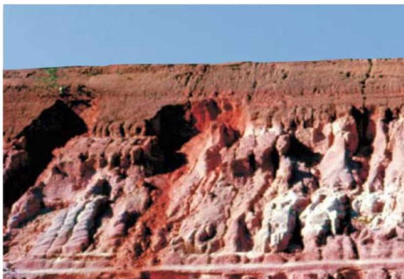
Figura 7- Diferença de comportamento entre solos tropicais presentes em um corte de um talude rodoviário.
