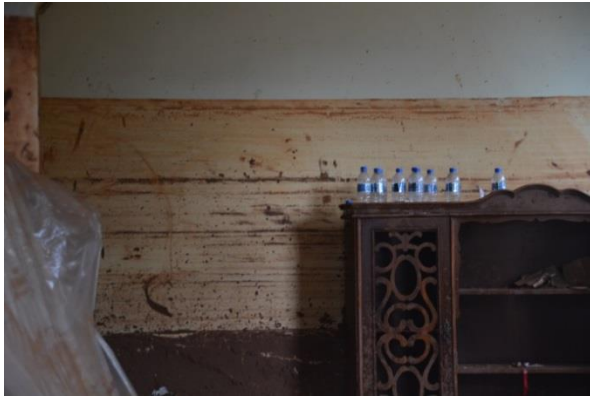
Foto 53: Marcas da enchente na parede interna de uma casa.
