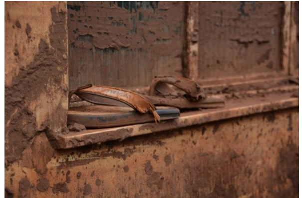
Foto 54: Detalhe do parapeito de uma janela, que foi ultrapassado pela lama.
