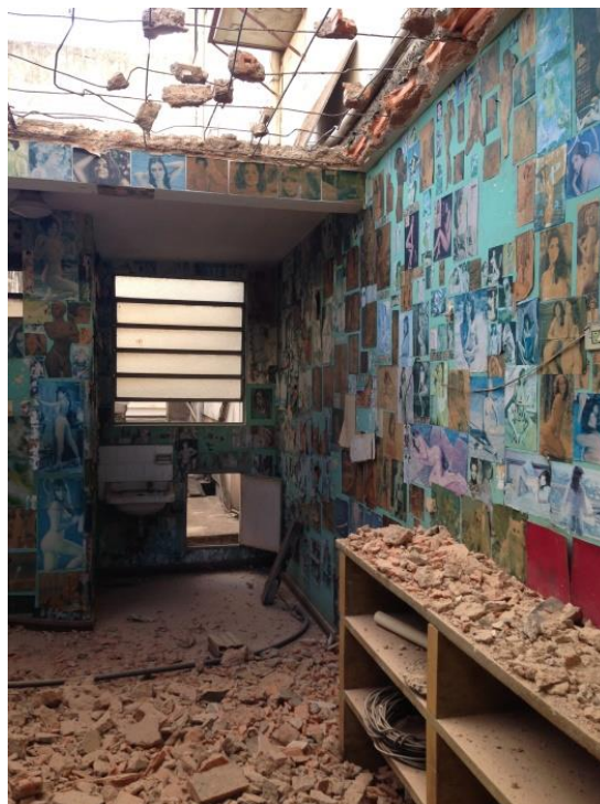
Ruína da sala de projeção do Riviera. Lista de filmes projetados em abril de 1977, com anotação do tipo de lente utilizada, censura, distribuidora. Fotos de revistas pornográficas espalhadas pelas paredes. Fonte: Imagens gentilmente cedidas por Luís Eduardo Falcão.
