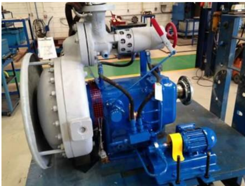
Figura 19. Turbina de acionamento da bomba de alimentação de água da caldeira de recuperação de gases da Ustulação. Fonte: fornecido pela empresa.
