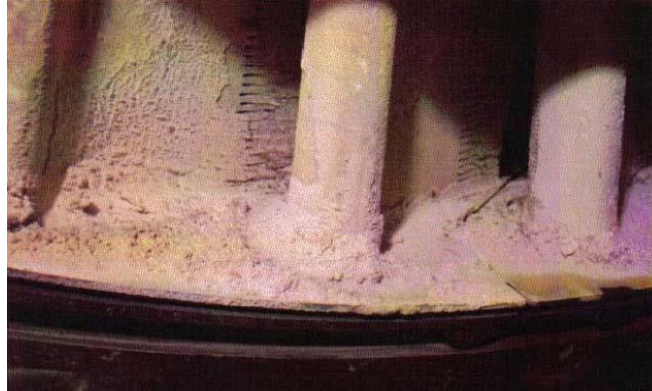
Figura 4: Acúmulo de material nas palhetas de uma turbina
