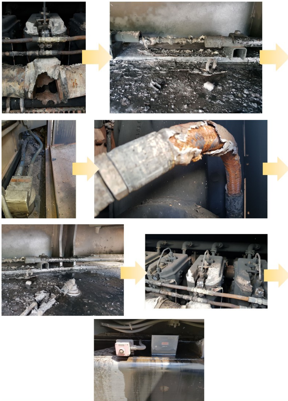
Figura 23: Componentes incendiados e origem do incêndio (Cilindro 2 Lado Direito) Fonte: Autor
