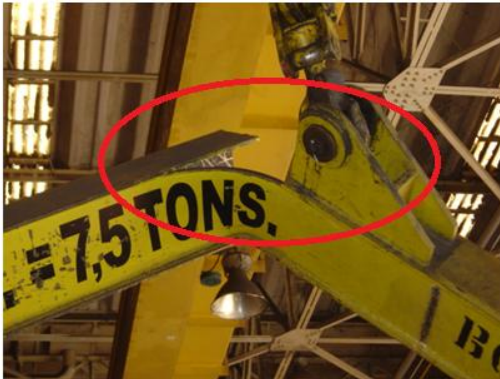
Figura 10 - Vista frontal da falha na barra de carga
