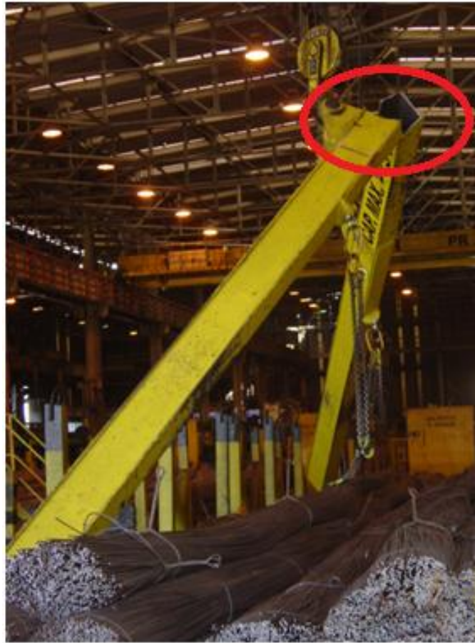
Figura 9 - Vista lateral da falha na barra de carga
