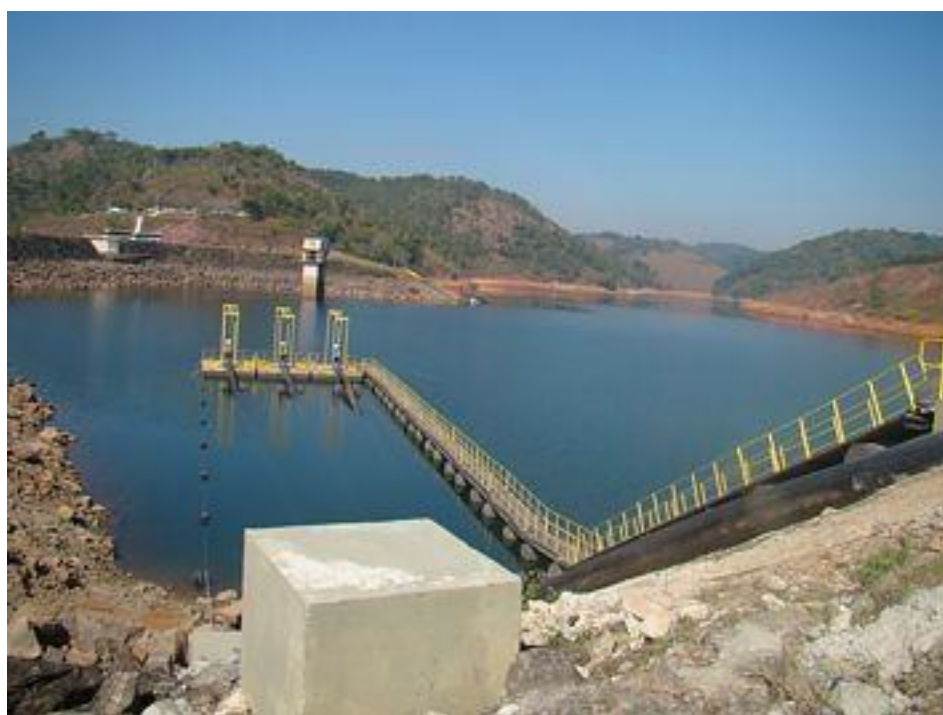
Figura 2: Adutora da Represa de Chapéu D'Uvas.
