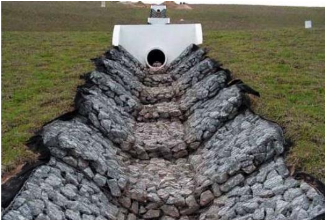
Figura 19 - Parte do sistema de drenagem superficial de um aterro.
