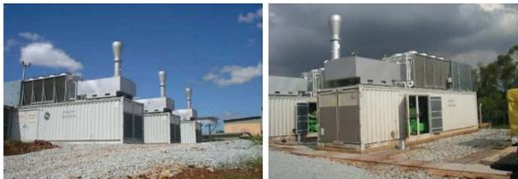
Figura 18 - Reaproveitamento de biogás do Aterro Sanitário de Belo Horizonte.
