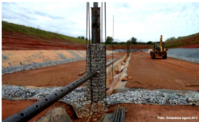
Figura 17 - Dreno de gás envolto com brita de um aterro.
