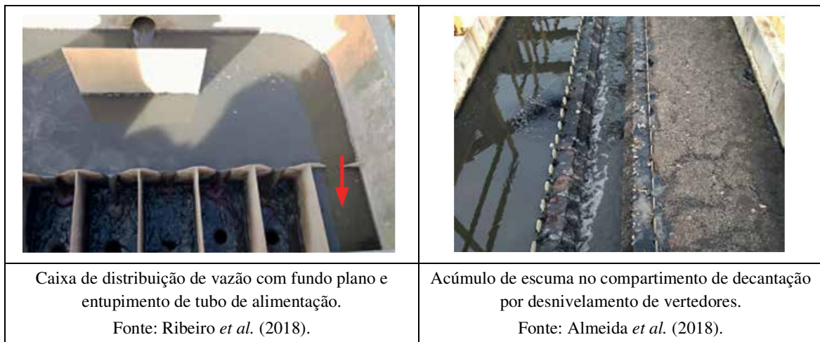
Figura 5. Problemas associados a entrada do esgoto e saída do efluente tratado em reatores UASB.
