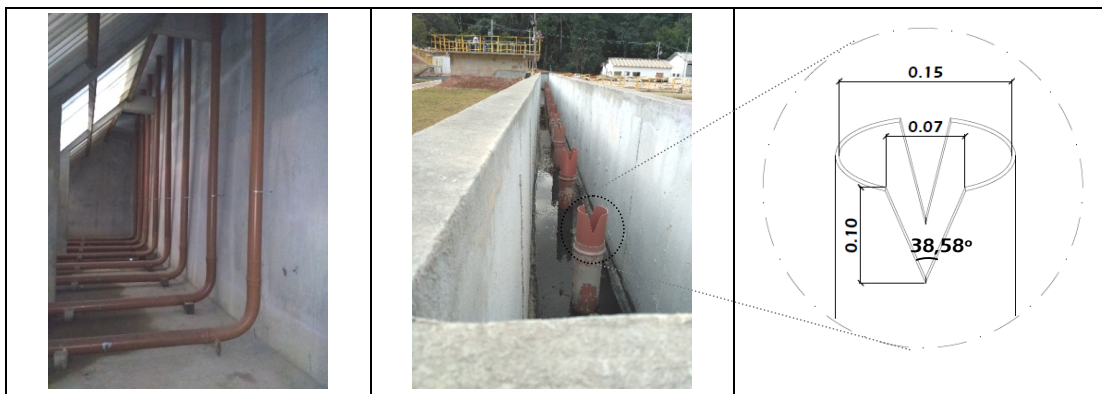
Figura 12. Tubos para distribuição do afluente nos reatores UASB. A esquerda, vista interna do reator; à direita, tubos e vertedores triangulares no canal de distribuição de esgoto bruto.
