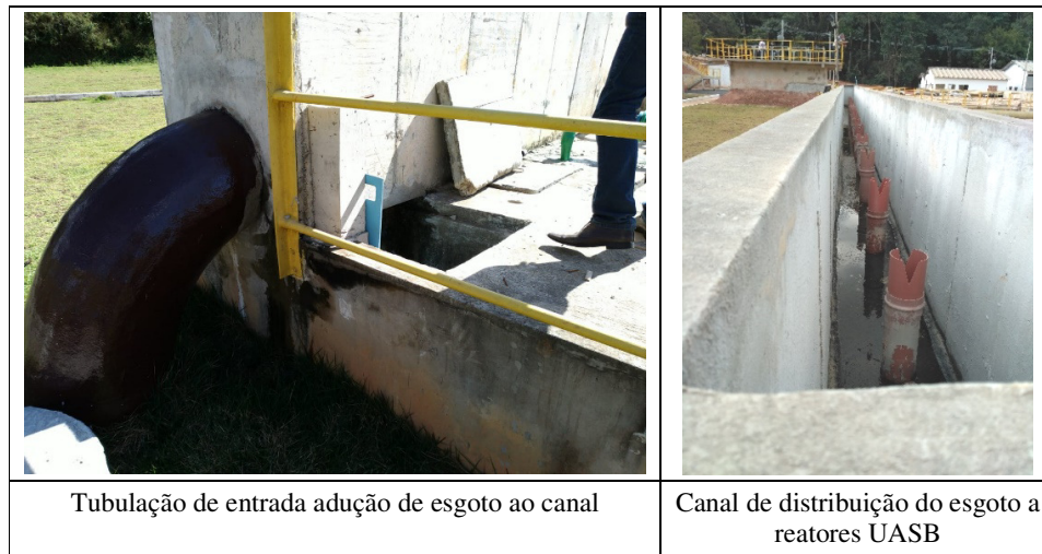
Figura 11. Adução de esgoto e canal de distribuição da fase líquida para o interior de reatores UASB.
