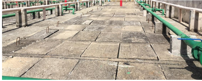
Figura 16. Placas pré-moldadas de concreto acima dos compartimentos de decantação dos reatores UASB.
