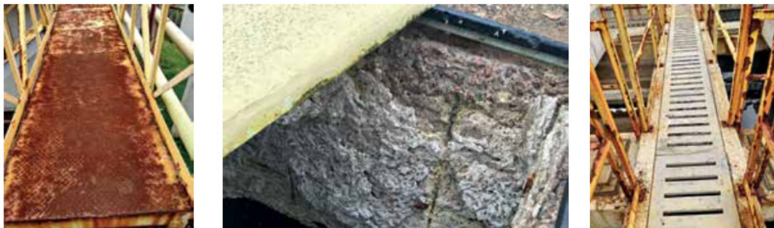
Figura 8. Corrosão de estruturas em ETE.
