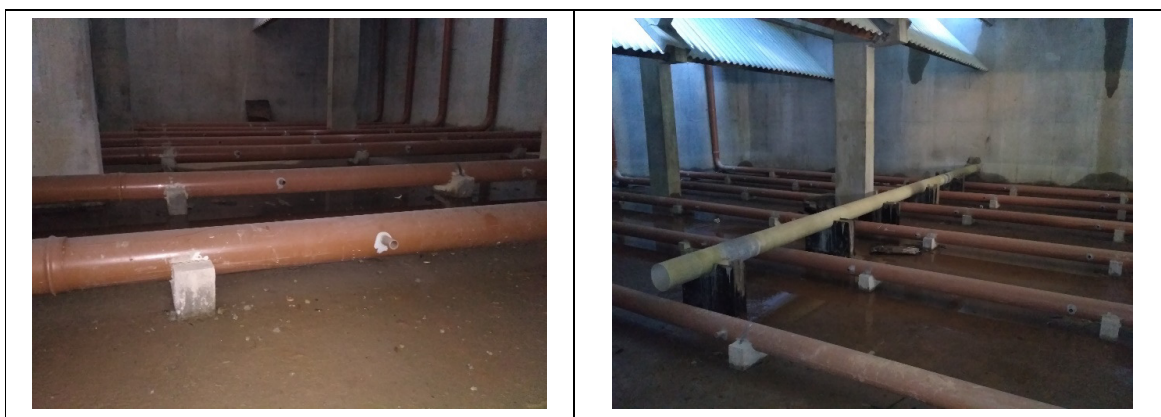
Figura 13. Tubos de distribuição do afluente no fundo e bocais nos reatores UASB.
