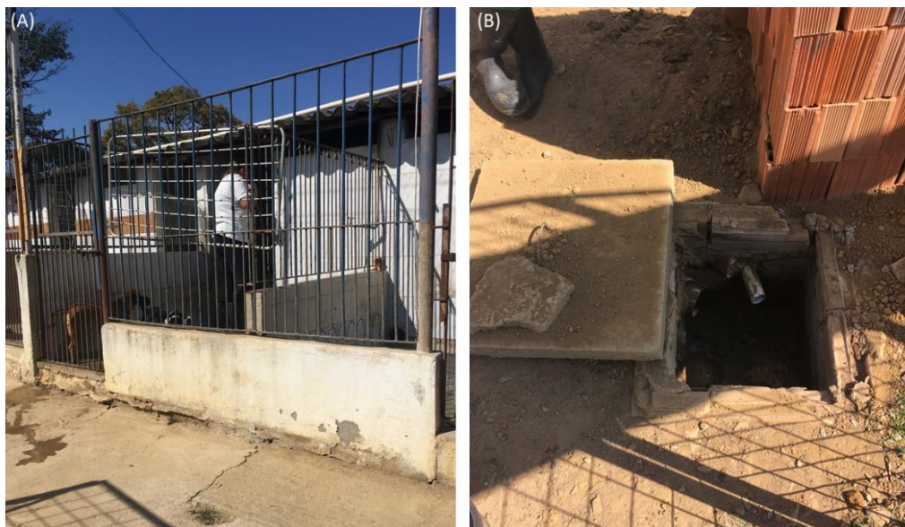
Figura 9 – Indicação das baias interligadas ao ponto de coleta 1 (A) e detalhe da tubulação aparente do ponto de coleta 1 (B).
