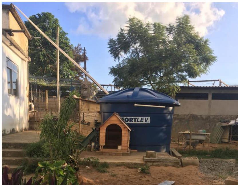
Figura 5 – Reservatório principal com capacidade de 10 m 3 .
