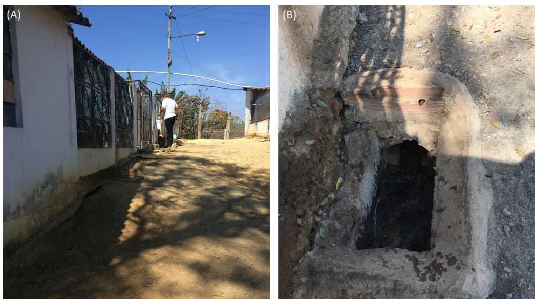
Figura 10 – Indicação das baias interligadas ao ponto de coleta 2 (A) e detalhe da tubulação aparente do ponto de coleta 2 (B).
