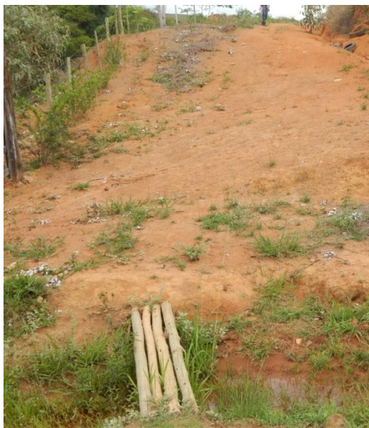
Figura 11: Estrada não pavimentada, trecho 3, próximo ao exutório. Fonte: Acervo do autor.
