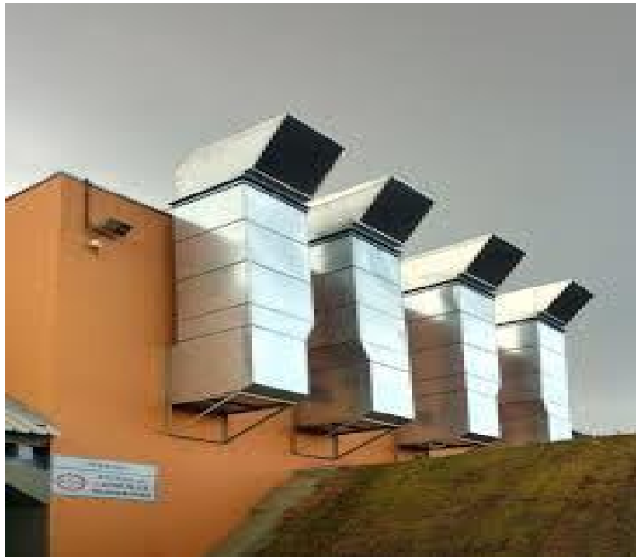
Foto 7 - Sistema de exaustão da Estação de transbordo. Fonte: operastudio. 2013
