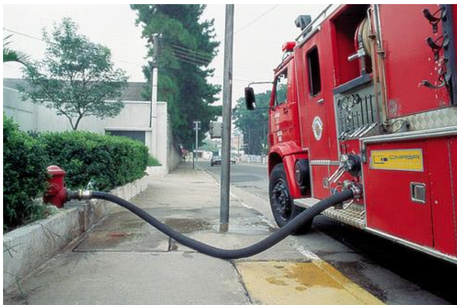
Figura 1 – Hidrante urbano em uso
