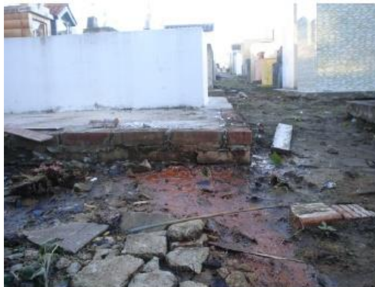
Figura 1: Vazamento de necrochorume de sepultura.
