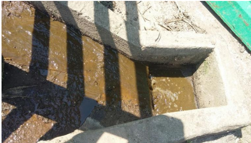
Figura 15 - Coletores do tipo canaleta através dos quais os efluentes são direcionados até pequenas caixas e dessas até o corpo hídrico
