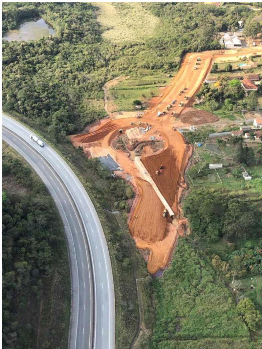
Figura 4 – Intersecção da BR-440 com BR-040, com canalização do córrego Grota do Pinto.
