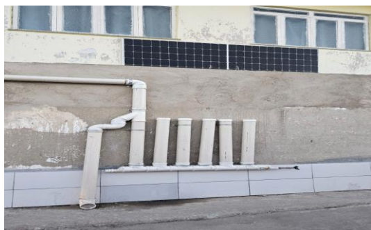
Foto 3: cisterna vertical de captação e armazenamento de água instalada na AMAC, no bairro Vila Alzira.
