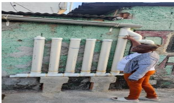
Foto 2: cisterna vertical de captação e armazenamento de água de chuva instalada no Novo São Bento.
