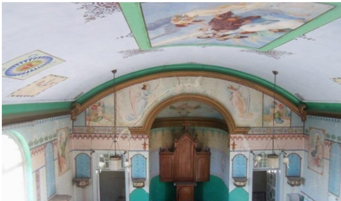
Imagem 2 - Púlpito e altar da capela, vistos do mesanino da Capela. Detalhe na rachadura proeminente no arco da semicúpula. Fotografia: Aline Vasconcellos. Agosto de 2015.
