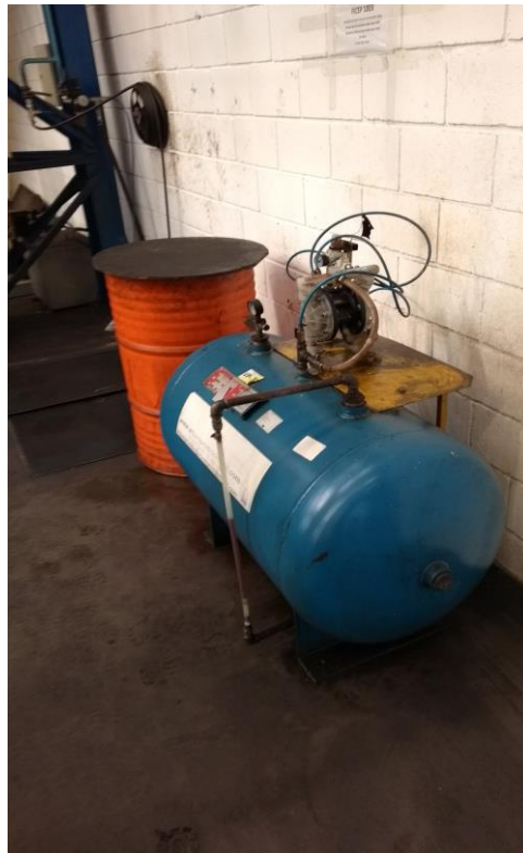
Figura 7: Bomba para retorno do fluido à máquina Fonte: Autor
