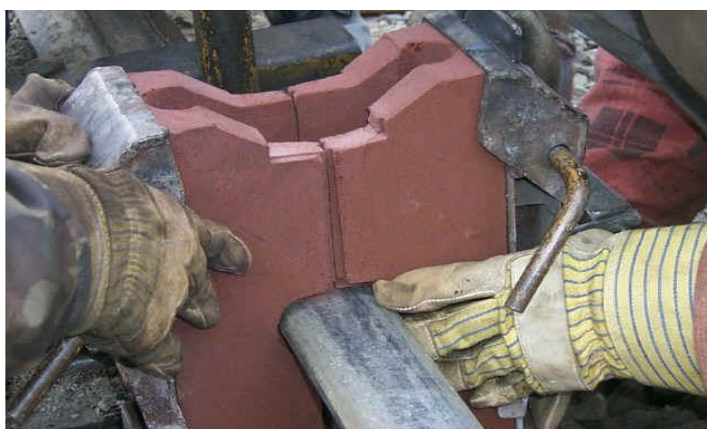
Figura 14: Molde montado e fixado por cinta metálica. Fonte: Equipe do projeto (EFC, 2016)
