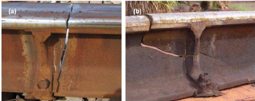
Figura 31: (a) Fratura vertical ( straight breaks failures ) em solda aluminotérmica, iniciada no patim; e (b) Fratura horizontal ( horizontal split web failures ) iniciada na região da alma do trilho.
