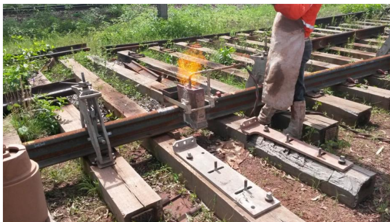
Figura 16: Processo de pré-aquecimento utilizando maçarico oxi propano. Fonte: Equipe do projeto (EFC, 2016)
