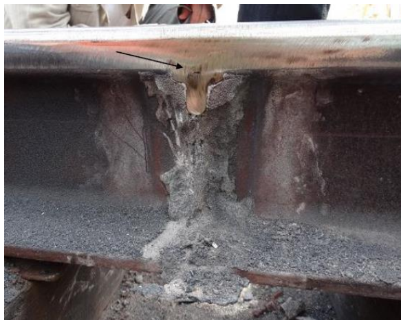
Figura 38: Evidência de defeito visual na amostra RS12.
