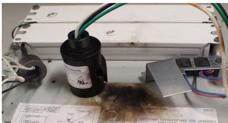
Figura 113 – Detalhe do varistor queimado de uma luminária LED.
