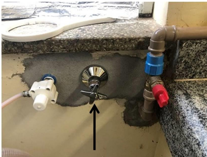
Figura 2- Indicação da válvula de fornecimento de água para a máquina de gelo.
