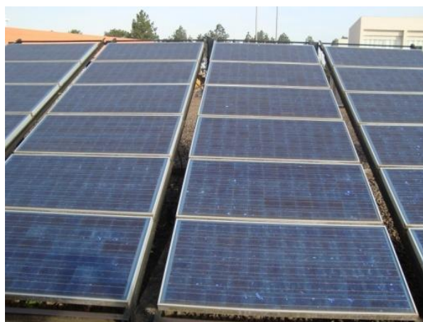
Figura 5.1: Foto dos arranjos com os painéis fotovoltaicos.
