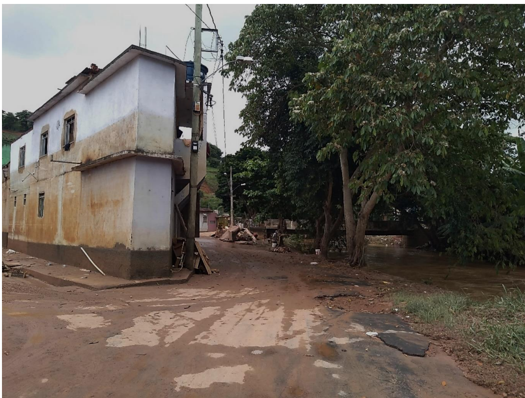
Figura 18 – Marca da cota de inundação nas paredes do imóvel no ponto mais baixo do Bairro João Clara, em Espera Feliz-MG, após a inundação de janeiro de 2020.
