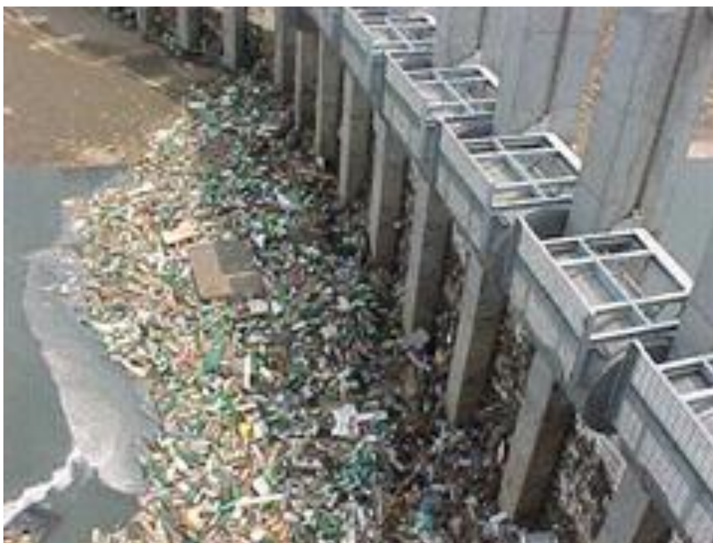
Figura 6 - Obstrução e resíduos no sistema de drenagem
