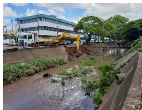
Figura 7 - Córrego Retiro Saudoso - Ribeirão Preto/SP. Canal retilíneo trapezoidal, de concreto e acabamento regular.
