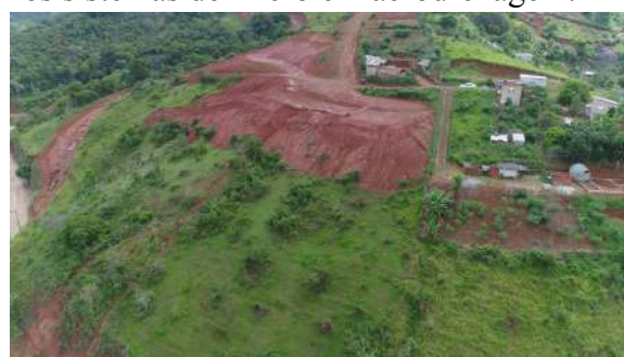
Figura 43 - Ponto 15 - Vista de encosta declivosa com presença de aterros lançados apresentando feições erosivas. Porções deste solo carreado, podem contribuir para danos nos sistemas de micro e macrodrenagem.
