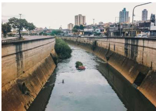
Figura 6 - Canal do Aricanduva - São Paulo/SP. Canal com paredes de concreto e fundo de enrocamento/material granular.
