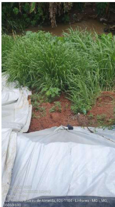
Figura 47 - Ponto 18 - Vista do Ribeirão Yung em sua seção próximo a Penitenciária Professor Ariosvaldo Campos Pires. No local é possível visualizar um escorregamento de talude marginal ao curso d'água.
