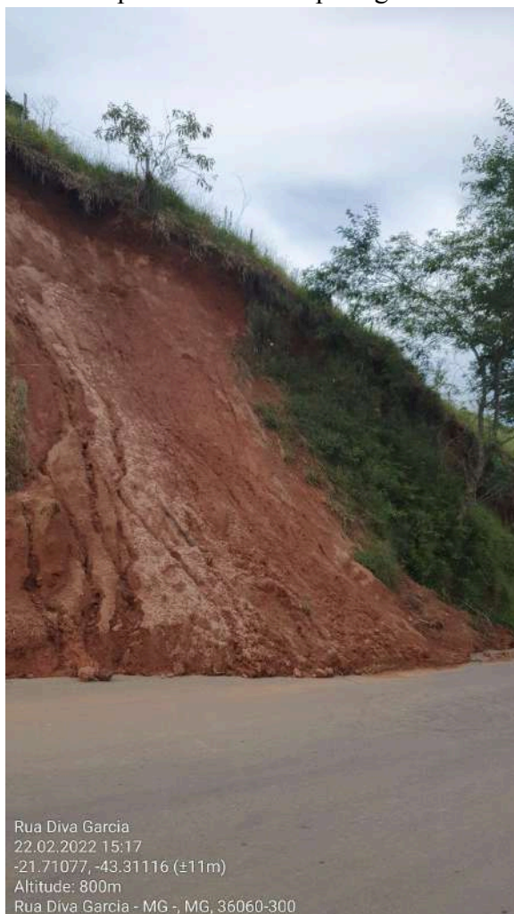
Figura 29 - Ponto 01 - Cicatriz de escorregamento de talude - em área com cobertura predominante de pastagens.
