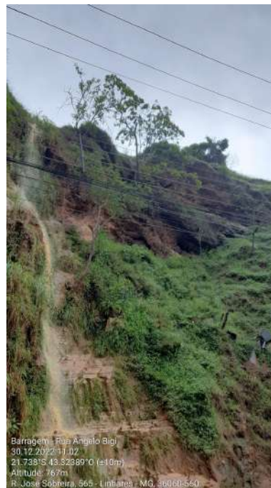
Figura 56 - Ponto 27 - Condição de escoamento superficial sobre maciço rochoso localizado à Rua José Sobreira em dia chuvoso.
