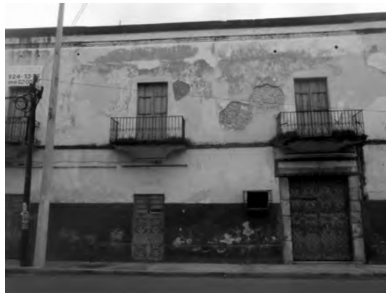
Foto 2. Abandono y deterioro del patrimonio edificado en el centro histórico de Mérida, octubre 2015. Fotografía de Susana Pérez..
