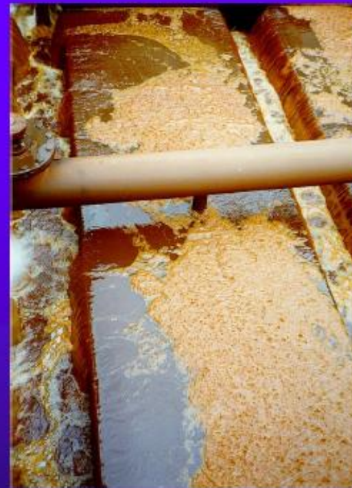
ÁGUA DE LAVAGEM DOS FILTROS
