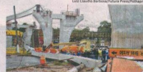
Viga da linha 18-ouro caiu na av. Roberto Marinho
