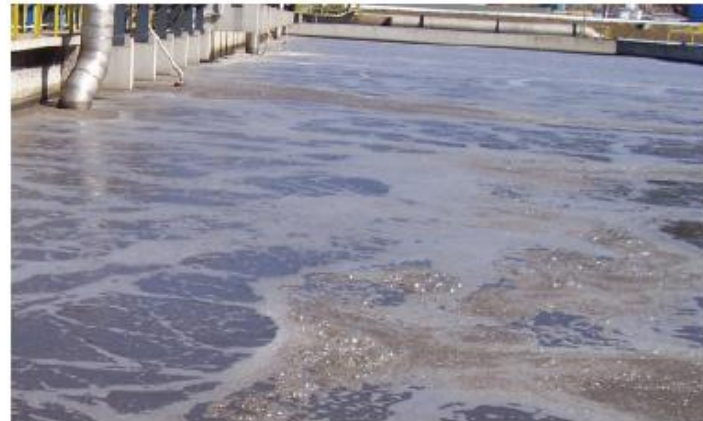
Tanque de areação
