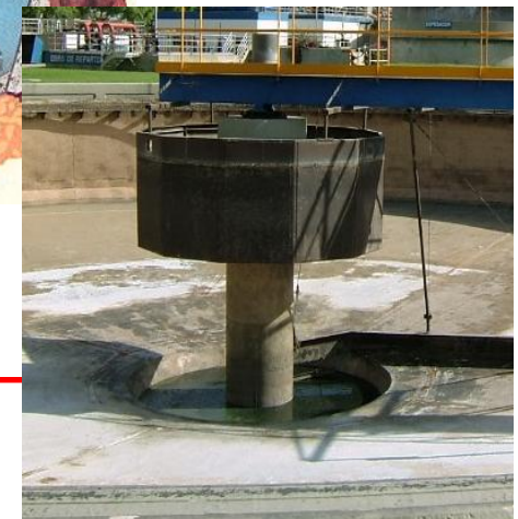
Sistema de alimentação da unidade e caixa de acumulação de lodo
