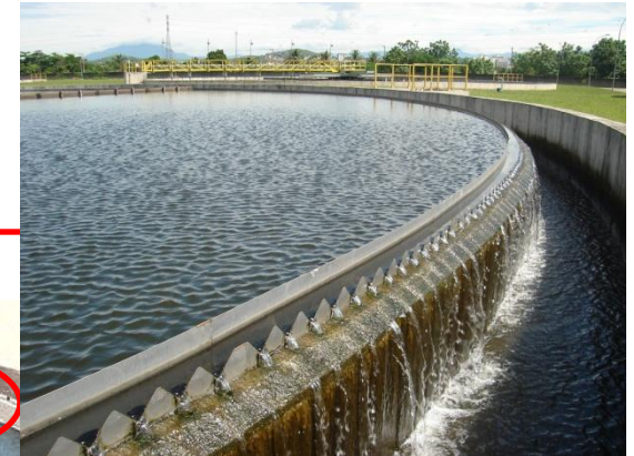
Calha coletora de efluente
