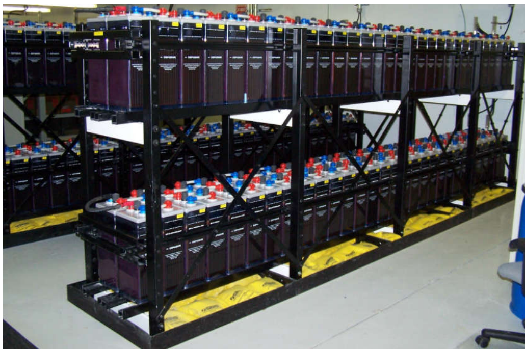
Figura 6 - Banco de Baterias Chumbo-Ácido
