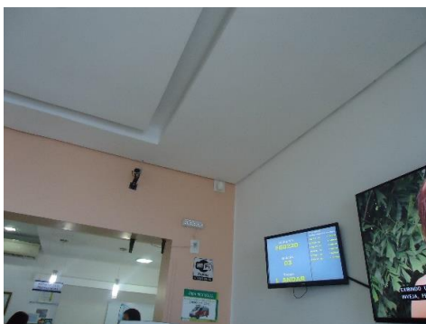
Figura 61: Instalações elétricas no interior do edifício
