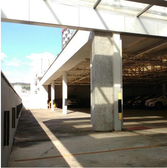
Figura 46: Estacionamento ausente de cobertura
