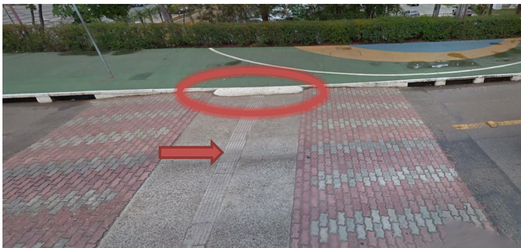
Figura 37 – A reforma das calçadas as deixou mais altas que o piso elevado da travessia de pedestres.
