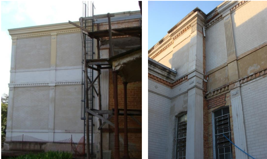
Figura 87 e figura 88: Fachada posterior não concluída.
