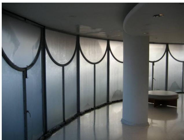
Figura 4.3 - Condensação no interior do museu (JEROME, 2009).
