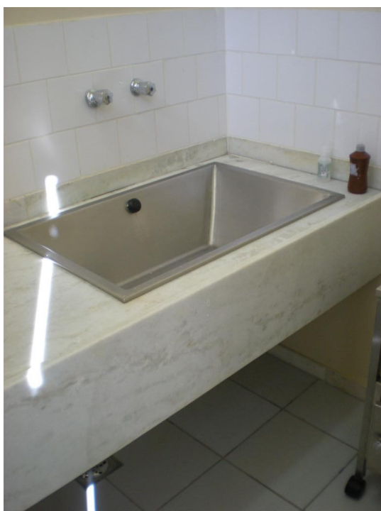
Figura 31 – Banheiro embutida (Fonte: a autora).
