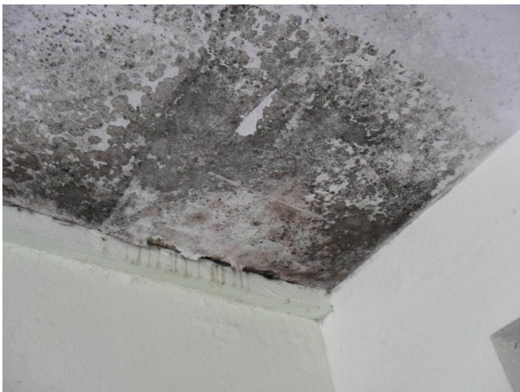
FIGURA 12 - Infiltração pela laje de cobertura
