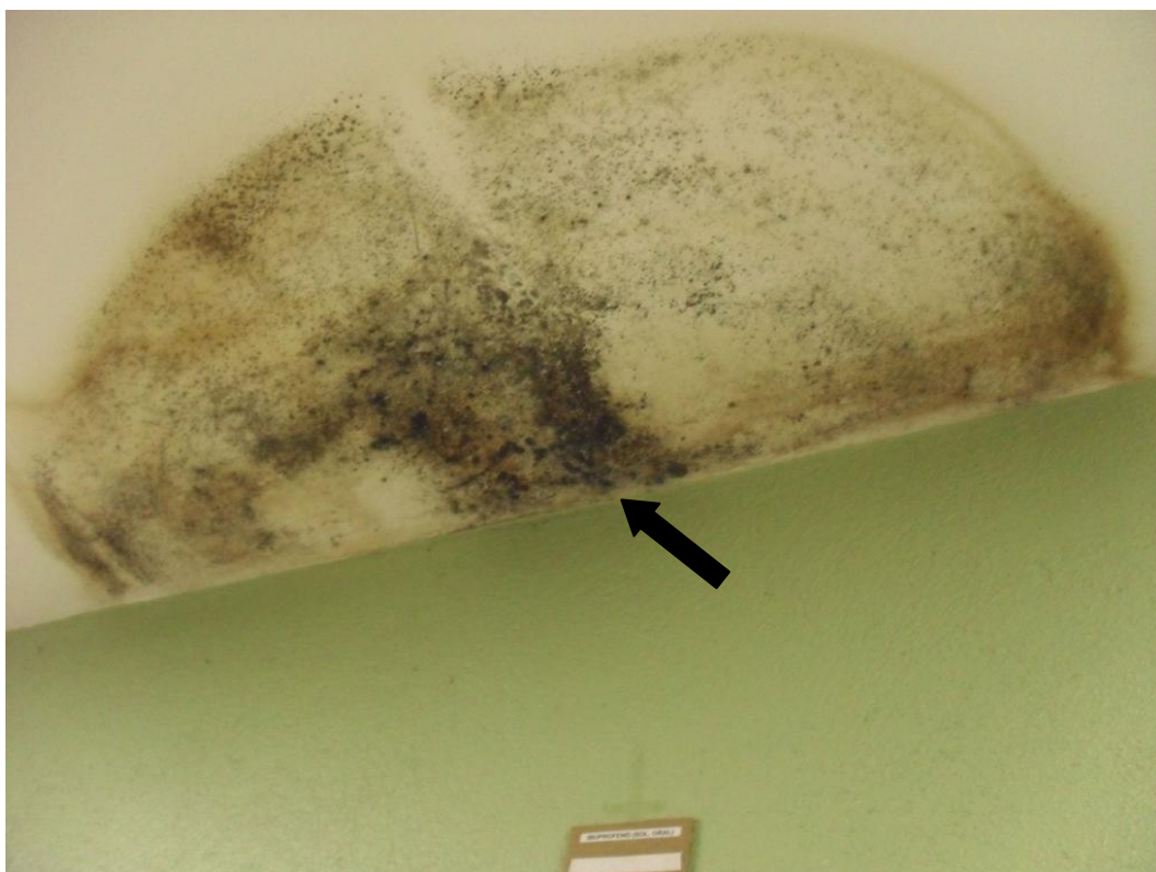
FIGURA 16 - Presença de microorganismos devido à umidade
