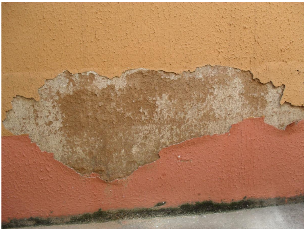
FIGURA 15 - Desplacamento do revestimento
