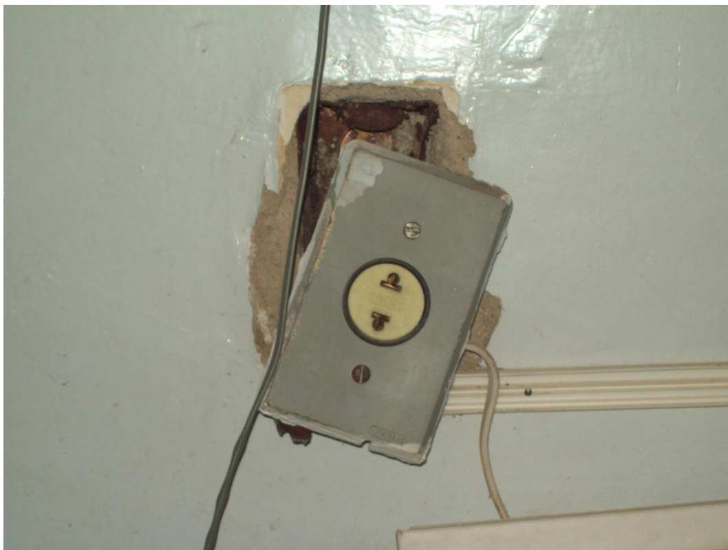
FIGURA 17 - Elemento de instalação elétrica danificado
