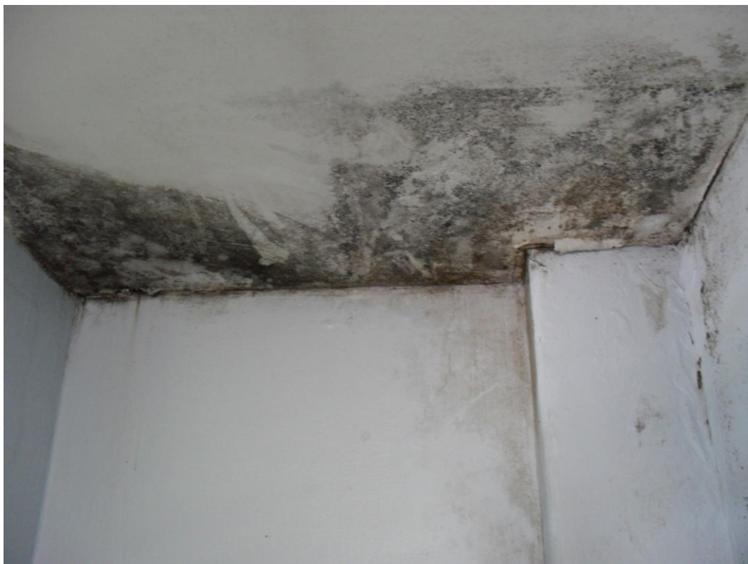
FIGURA 13 - Infiltração pela laje de cobertura
